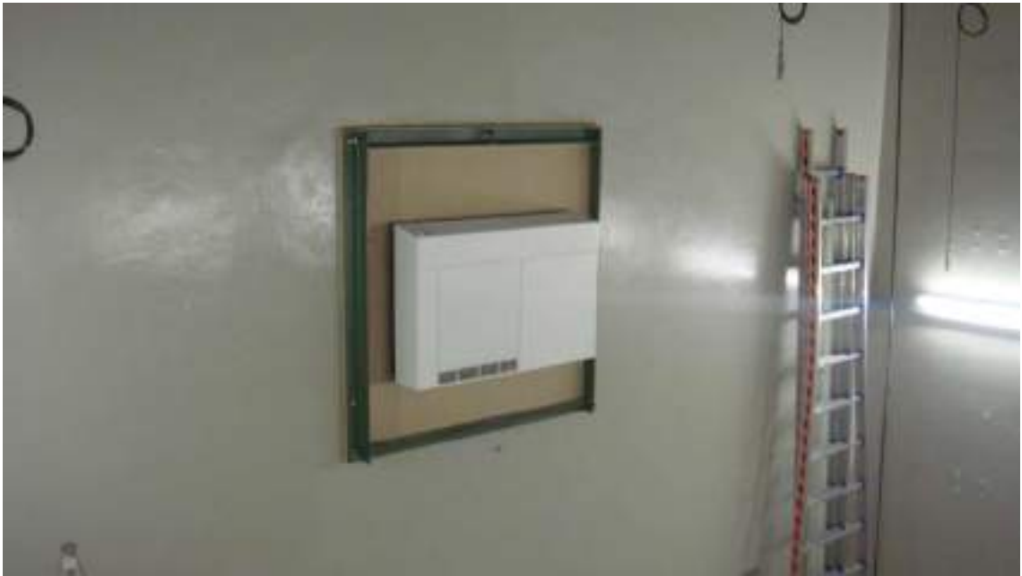
Foto 1: Einzelraum-Klimagerät im Hallraum
